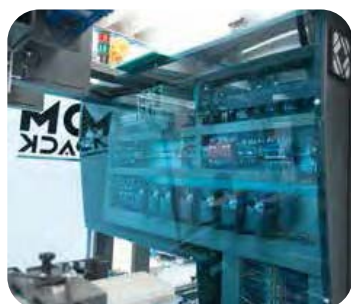
Ηλεκτρολογικός πίνακας εύκολα ορατός και προσβάσιμος.
